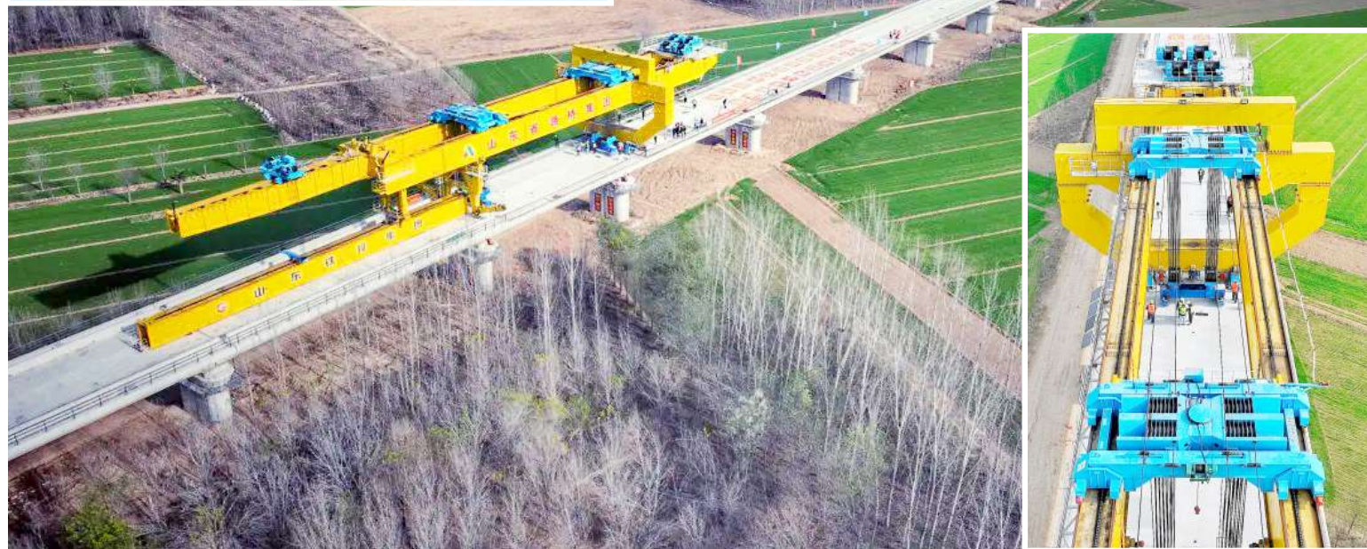
津浦高铁济南联络线(济滨高铁) 项目投资374.2亿元 建设工期4年 正线全长145.299KM 设计时速350公里
