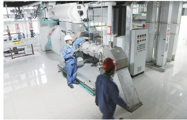
山东香驰粮油有限公司新建年产6万吨过瘤胃蛋白饲料生产线竣工投产。
